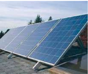
Fig. 8.2.6 Paneles solares para precalentamiento de agua de consumo.
