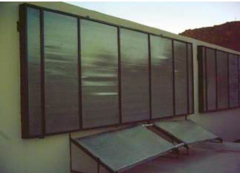
Fig. 8.5.4 Vista de los colectores (calentadores) de aire y de los colectores (calentadores) de agua.
