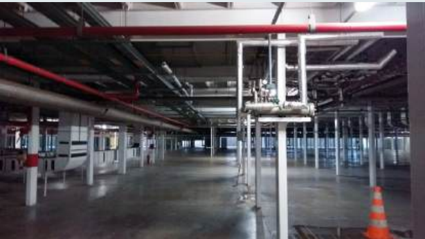
Fig. 6.3.1 Foto del entresuelo técnico por donde circulan los troncales de instalaciones y se ubican salas de máquinas. Además, se utiliza para el ingreso y enfriamiento natural del aire antes de ser inyectado a los locales de la planta baja.
